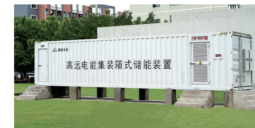
远光软件园园区储能装置
